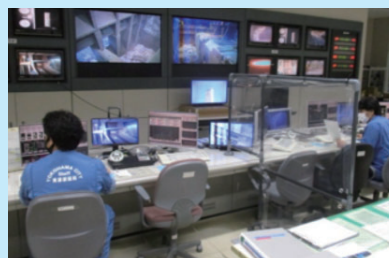
▲中央管制室 かんせいしつ の様子
