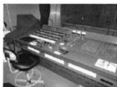
【照明調光卓/故障部品入手困難】
