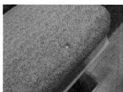
【ホール座席/座面の破損・汚損】
