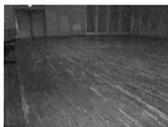
【ホール舞台床面の劣化】
