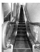
【エスカレーター/減速機の劣化】
