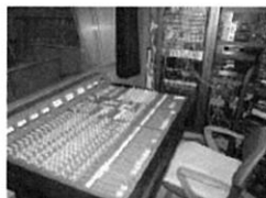
【音響調整卓/第1期工事完了】
