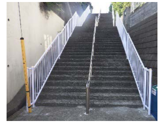
公道に設置した手すり
