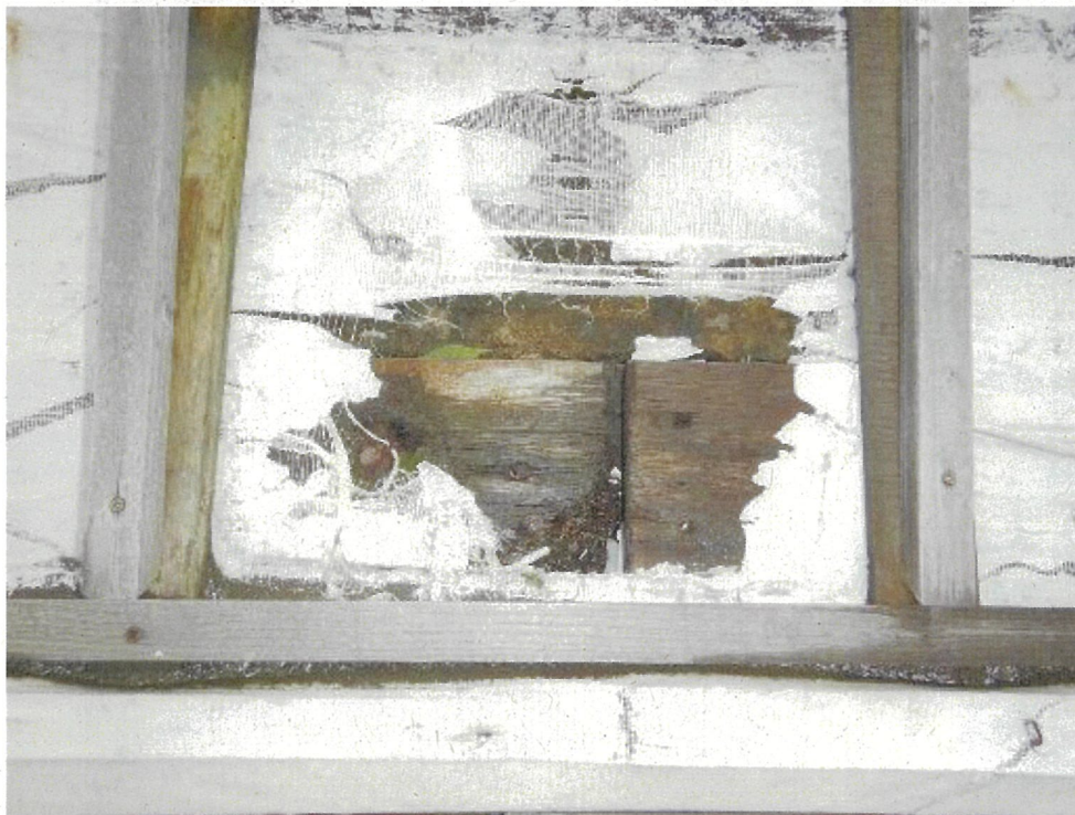
写真 9 屋根瓦破損部分の軒先詳細
