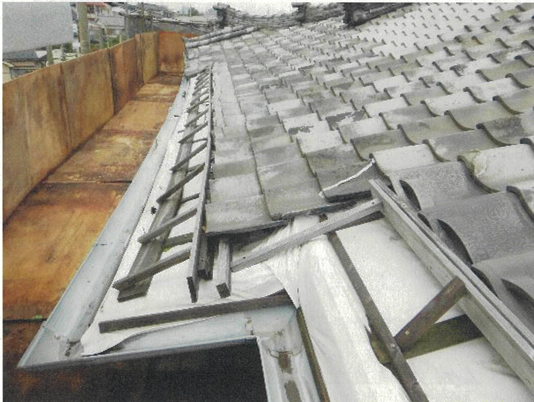
写真8 屋根瓦破損部分
