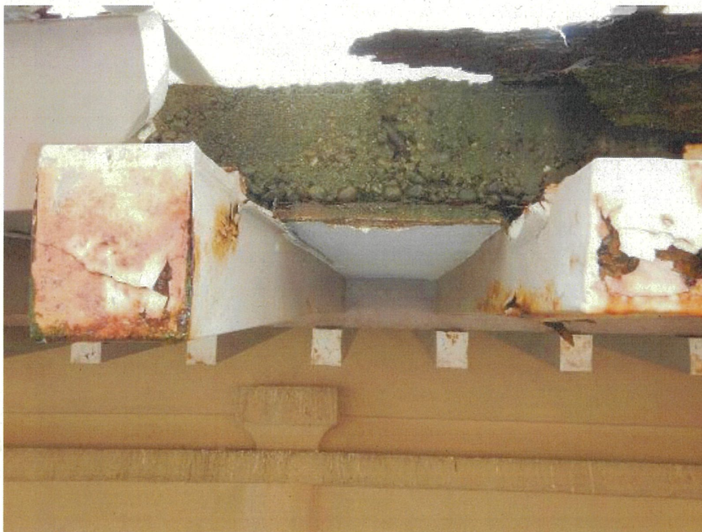
写真 10 屋根瓦破損部分の軒先詳細
