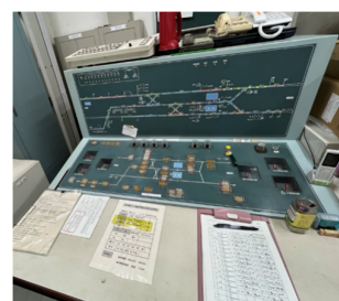
▲連動制御装置（新設）
