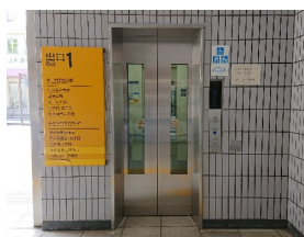
▲更新したエレベーター
