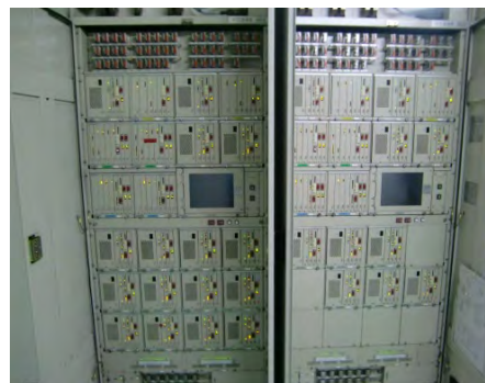
【更新後の ATC 装置】
