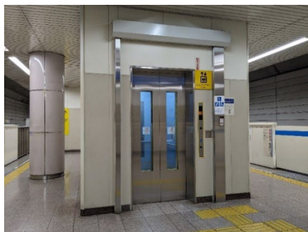
駅構内エレベーター (中田駅)
