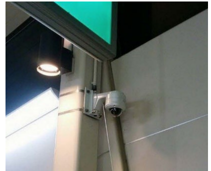
駅構内の防犯カメラ
