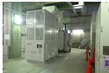
変電所機器・変圧整流設備
