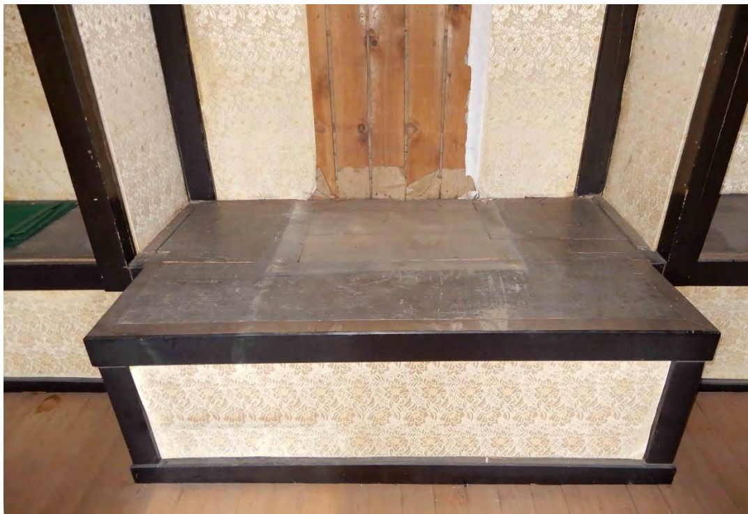
20 如来堂内部 丸柱列奥(内陣)中央の須弥壇 内陣須弥壇後方に厨子(宮殿)を配置した形跡が残る。また、仏後壁の唐紙は厨子の幅寸法よりやや内側まで張り付けて、その内側は施工しない。下地は現状以前の唐紙下貼らしい紙もみられる。ただし下地の縦板はあまり古くないように見える。
