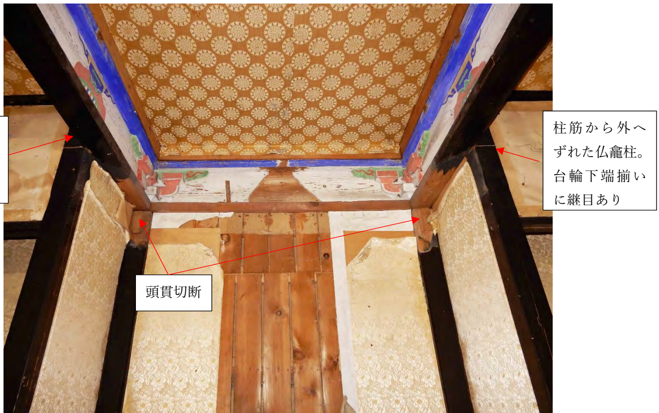
19 如来堂内部 丸柱列奥(内陣)の天井見上げ 丸柱と背面柱を繋ぐ頭貫を切除したのは、仏龕柱の変更を含めて現状宮殿安置のためと考えられる。この際、この部分の天井は棹縁を撤去して天井をかさ上げしてクロス張の鏡天井を設け、あわせて小壁部分に彩色や墓股の描画を施した。
