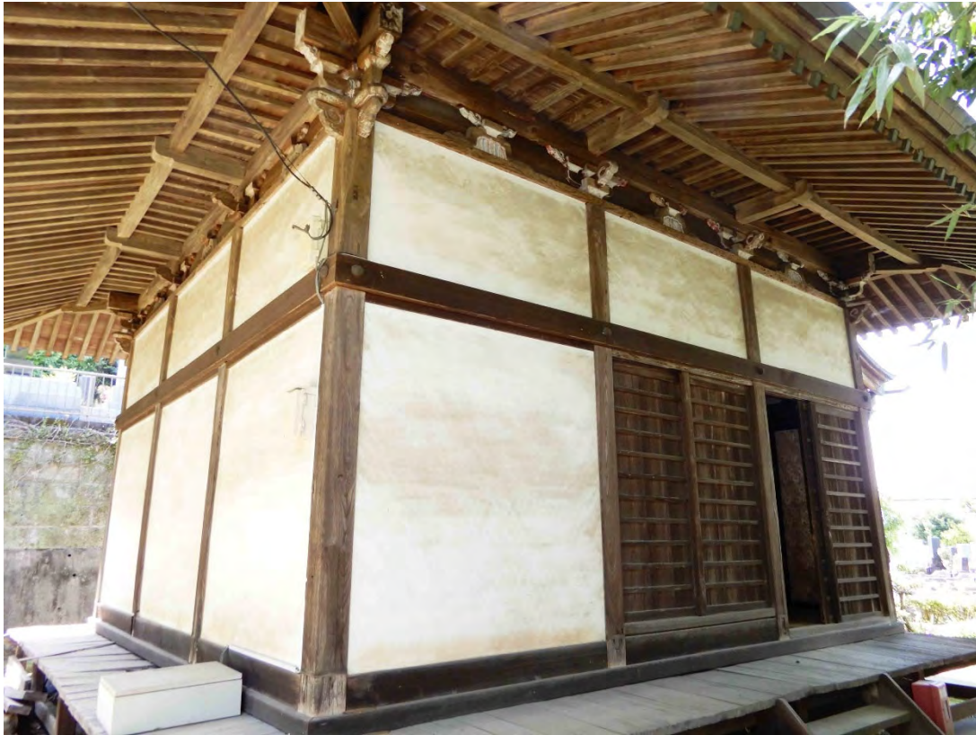
7 如来堂背側面（南東から見る） 側面は東側面・西側面とも前端間と中央間に引き違い舞良戸(マイド)の開口を設けている。中央間の建具の下辺位置が高いが、これは内部が上段になっていることに対応している。現在切目長押は4周同高に取り付くが、本来は背側面上段部分は長押を高い位置に取り付けていた痕跡が残る。
