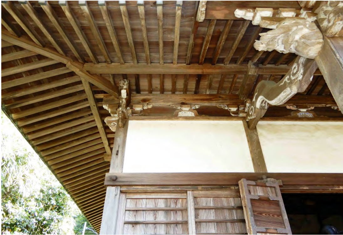
5 如来堂正面脇間の軒見上げ 頭貫木鼻と臺股の絵様と刳形はやはり18世紀後期頃の特徴を示す。出桁造の内側部分に垂木割と同じ根太を掛けているが、こうした形式は珍しく、軒回りを造り替えたときに採用したものであろう。
