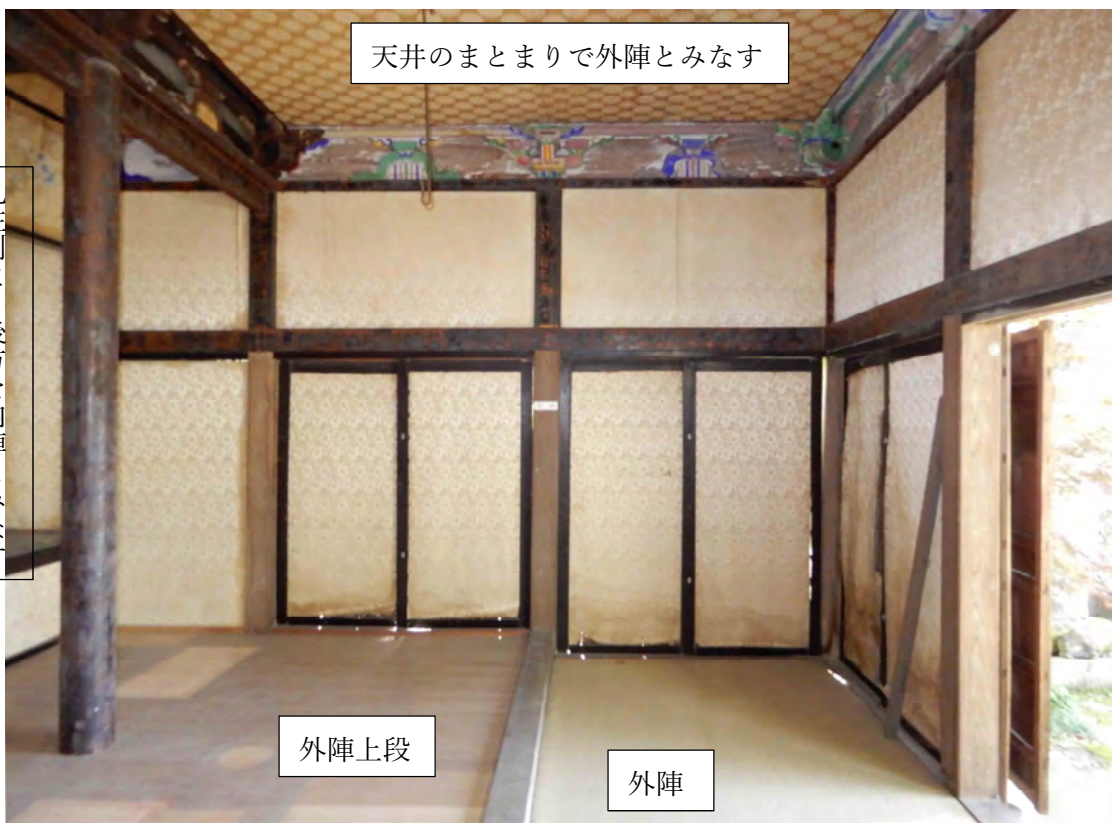
16 如来堂内部 西側面 上段区分と内部柱列の関係がよくわかる。間仕切がないのでどちらを内外陣境とするかの判断は難しいが、丸柱の柱列と天井区分で内外陣を判断すると写真の書入れのようになる。その場合、外陣後方が上段構えとなる。如来堂で法要を行う場合、外陣上段は僧侶の場となるという。以下の説明ではこの区分で説明する。一方上段框位置を内外陣境とすると、天井の区分との関係が説明しにくくなる。柱は全体的に頂部がやや前方に傾いているようである。天井は本来の天井(棹縁天井の可能性あり)の下に合板下地を設けてクロス張しているようである。
