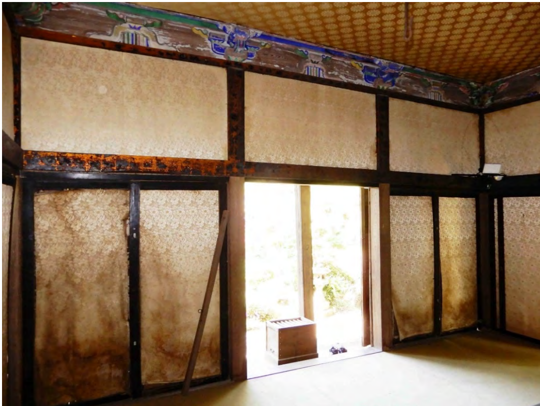
14 如来堂内部 正面を見返す。正面両脇間の舞良戸は雨の吹き込みが渗んでくるようで、唐紙の傷みが大きい。開口部の外部周囲に辺付(小木片)を取り付けることにより、雨水の吹き込みは一定程度防げるだろう。
