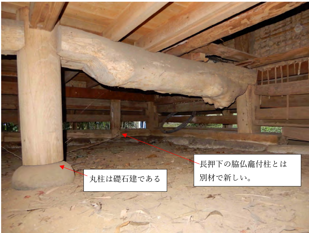
31 如来堂床下 (内部丸柱と背面柱を繋ぐ大引) 床板と根太はほぼ新材に取り替られているが、須弥壇下と脇仏龕下については古い床組が残っている。須弥壇下は床板の多くが取り外されている。側面には仏龕付柱と同じ位置には束立するが、これは長押下の束柱とは別材で比較的新しい。
