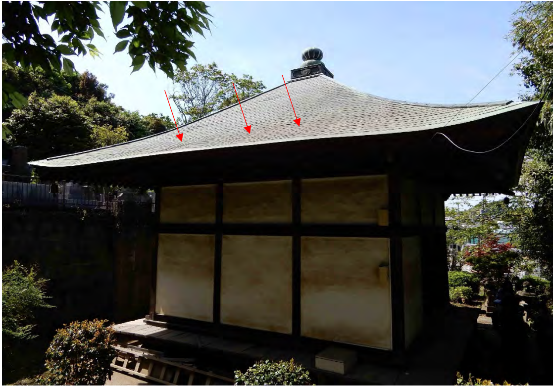
11 如来堂背面屋根全景 軒先付近の屋根面において盛り上がった部分が目立つ。一般的にこうした状態は、冬場に施工した銅板葺き屋根（伸縮した状態で施工）が、夏場に膨張することによって変形を来すものである。それを防ぐために施工時に一定の余裕を見るが、伸縮・膨張程度が想定以上であると、こうした変形を生じやすい。
