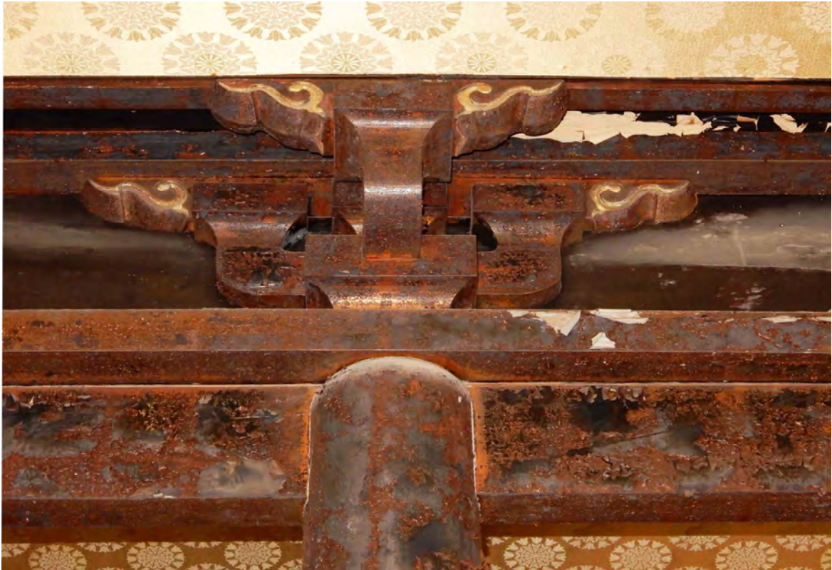
25 如来堂内部 丸柱上部と組物詳細 内部組物は前方2間分の見え掛かり範囲について出組形式を採用し、天井桁を1手分迫り出している。天井は天井桁のわずか上に鏡天井(板天井)を設けてクロス張として四分一で見切る。おそらく本来は棹縁天井で、棹縁下に合板下地張りしてクロス張りしたと思われる。塗装は、黒漆塗りしたうえで(琵琶板を除いて)金箔を施し透漆塗り(いわゆる白檀塗り)のようであるが、現状は漆面が縮んで剥離が進んでいる。実肘木絵様は金泥塗りしている。
