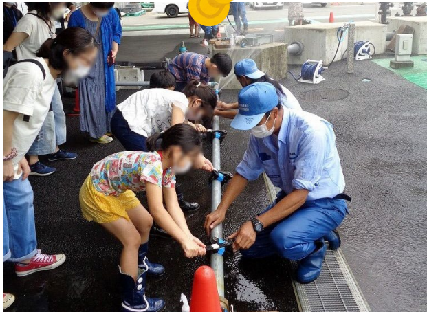
水漏れを直したよ！
