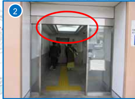
【鴨居駅ふれあい橋】 エレベーター出入口付近の照明の明るさについて改修を検討
