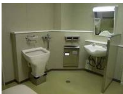
左：汚物流し 右：腹部洗浄台
