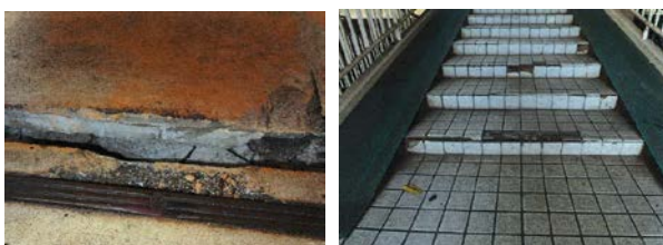
■ 施設老朽化の状況（施設内階段の破損）
