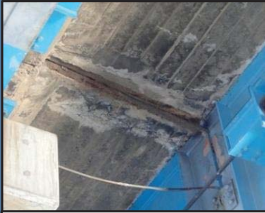
床版の劣化状況
