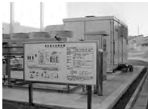
北部汚泥資源化センター燃料電池
