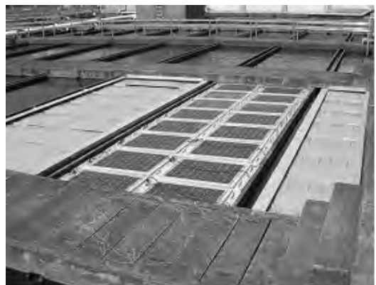
フロート遮光設備
