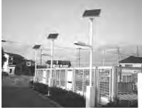
下飯田駅前 ソーラー・省エネ照明灯
