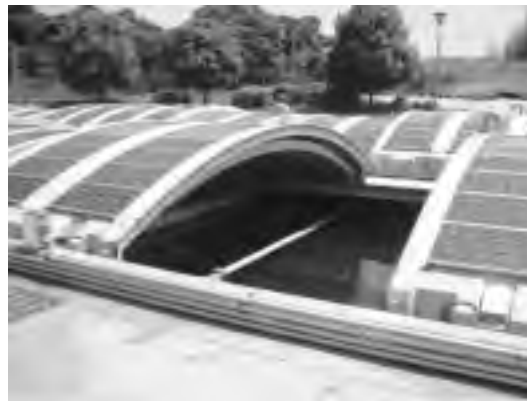
ろ過池の太陽光発電システム
