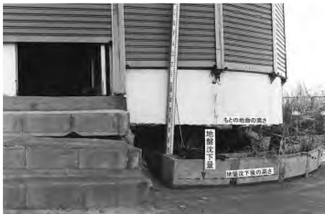
地盤沈下の顕著な例(1980年撮影 市内)
