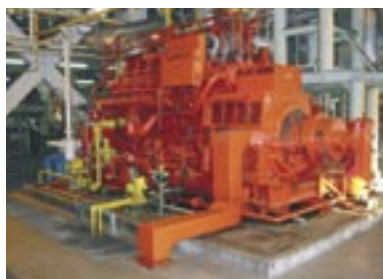
■消化ガスの有効利用 (ガス発電設備)
