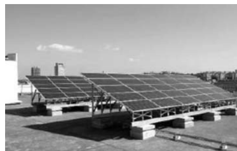
既に設置してある小学校の太陽光発電システム（南台小学校）
