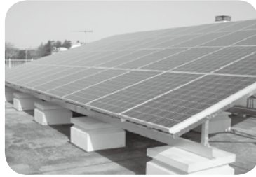
太陽光発電システム
