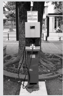
市庁舎駐車場の倍速充電スタンド
