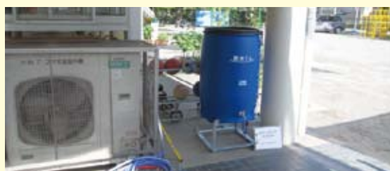
雨水貯留タンク
