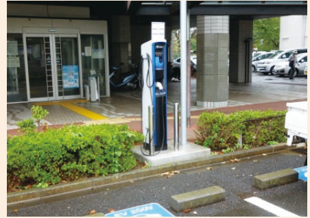
区役所に設置した倍速充電スタンド
