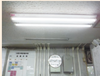
LED 照明に交換した土木事務所
