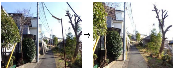
施工前 施工後 直営工事で、鋼管ポールを撤去し、近接の電柱へLED防犯灯を設置
