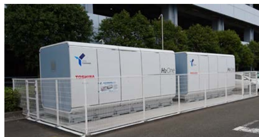
自立型水素燃料電池システム
