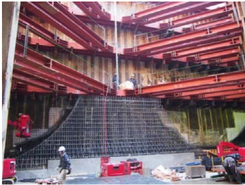
横浜環状北西線 シールドマシン発進立坑内部(緑区北八朔町)
