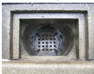
雨水浸透ます
