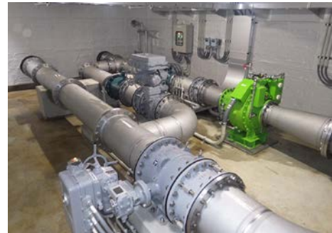
恩田配水池小水力発電設備
