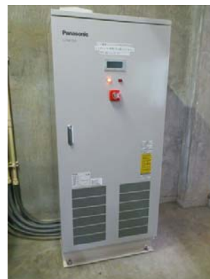
蓄電池の設置
