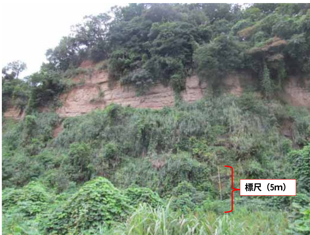
写真 2-1 計画地内の海食崖の状況（現況）
