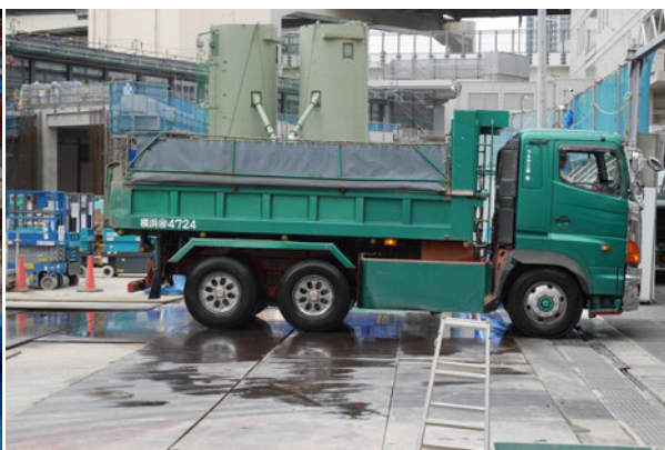
写真 3.3-10 飛散防止装置を装着したトラック
