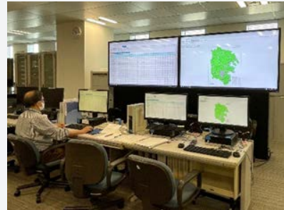
常時監視システム
