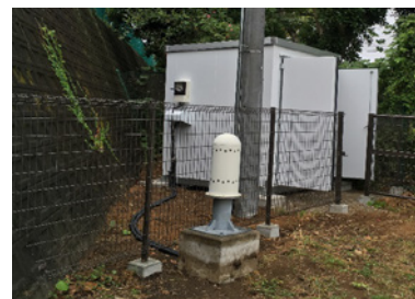
放射線モニタリングポスト (手前の白い構造物)
