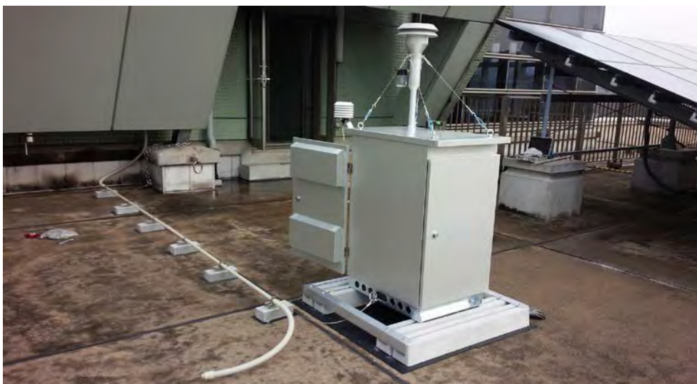
青葉区総合庁舎屋上に設置したPM2.5測定機 (H27.3.18撮影)
