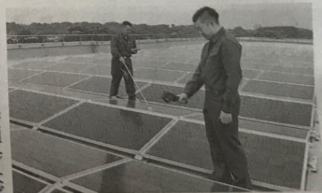
特別養護老人ホーム屋上の太陽光パネルを点検する太陽住建の社員＝横浜市戸塚区
