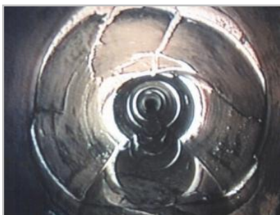
老朽化した下水道管
