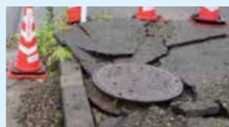
マンホール浮上被害状況
