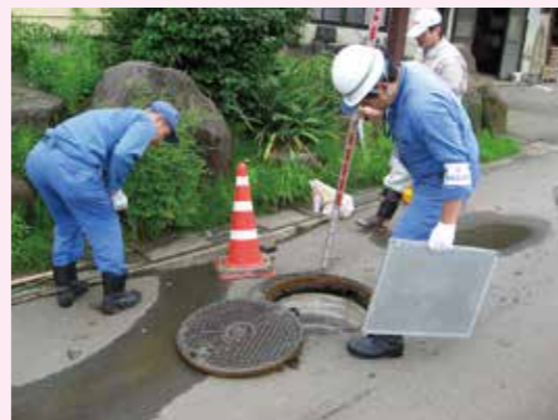
新潟県中越沖地震 調査時の様子
