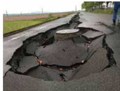
2016（平成28）年 熊本地震被害状況（下水道管）
