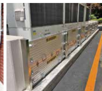
機械設備の耐水化 (止水板)
