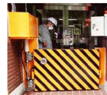
建物の耐水化 (防水扉)
