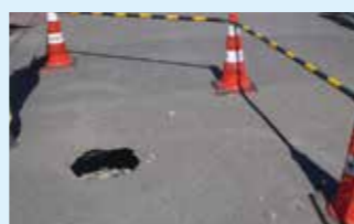
取付管破損による道路陥没
