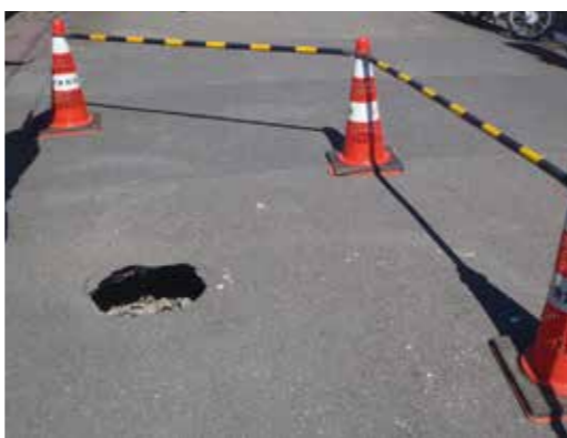
取付管破損による道路陥没
