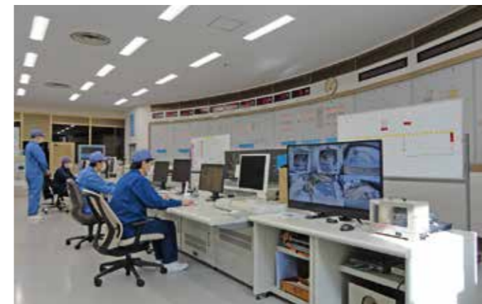
中央操作室での運転管理
