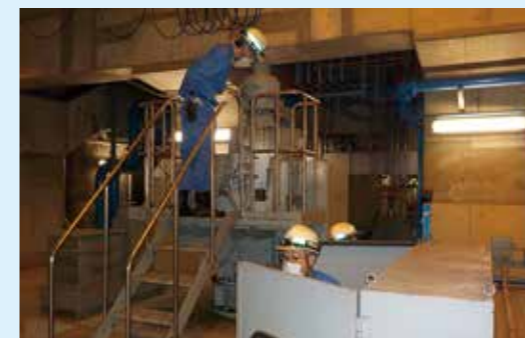
主要設備の点検 ポンプ設備
