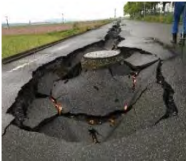
液状化による 下水道管の被害
