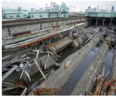
東日本大震災における 下水道施設の被害
