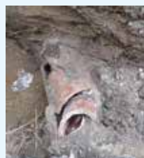
老朽化により 破損した下水道管
