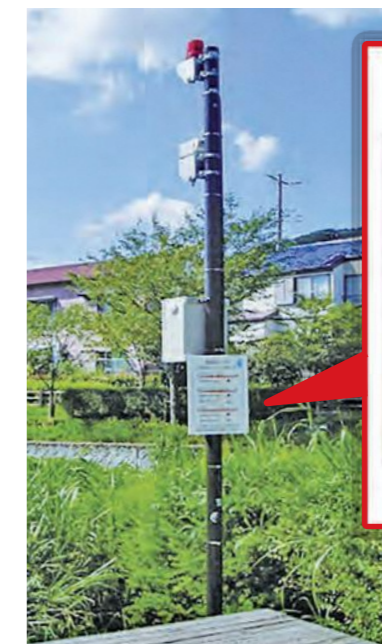
▲ 設置されている警報装置
