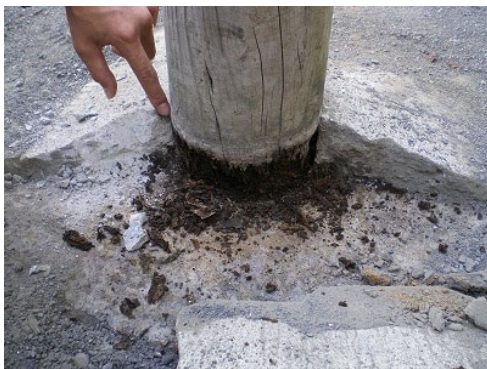
▲ 根際部の腐食（木製柱）
