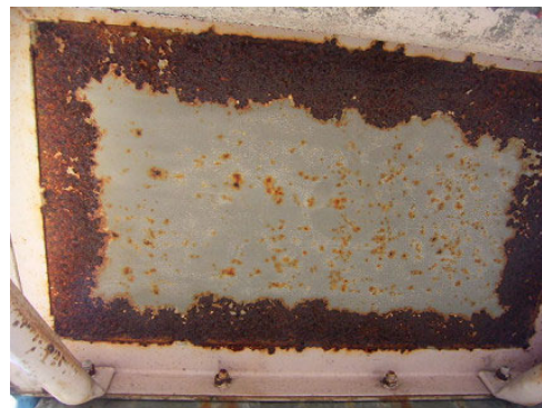
▲ 踊り場（裏側）の腐食
