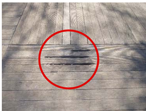
▲ 木製デッキ 床面破損（たき火あと）
