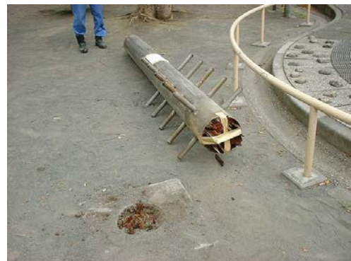
▲ 根際部の腐食による倒壊（木製柱）
