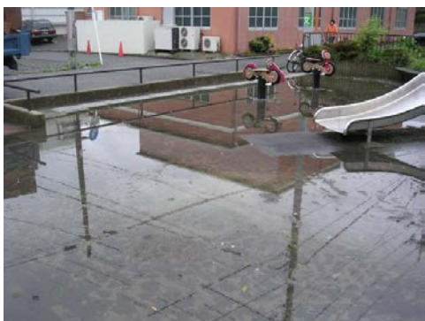
▲ 広場 排水不良
