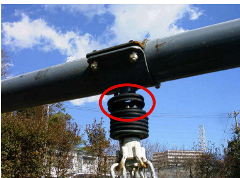
▲ 吊金具カバー破損
