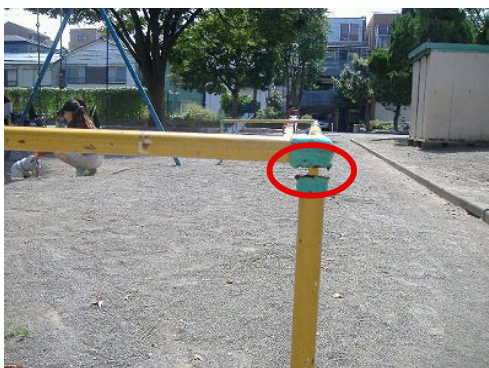
▲ ブランコ安全柵の継手金具の割れ
