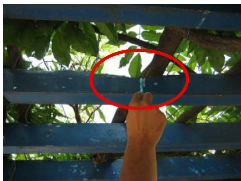
▲ パーゴラ 桟木腐食
