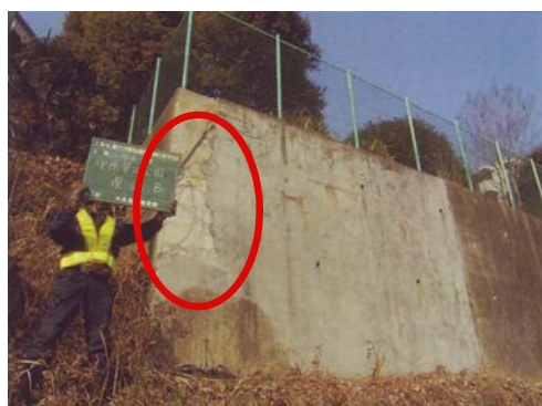
▲ 擁壁表面剥れ
