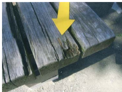
▲ 木製ベンチの腐食
