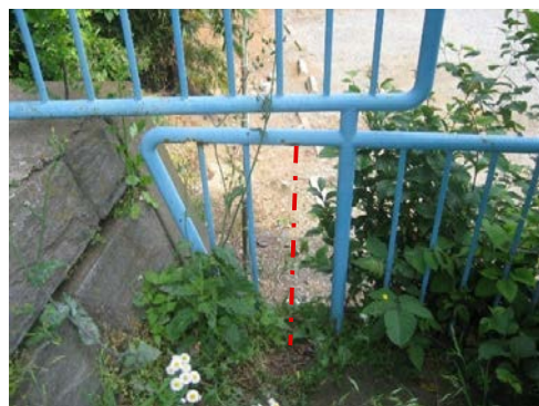
▲ 縦格子柵 部材欠損
