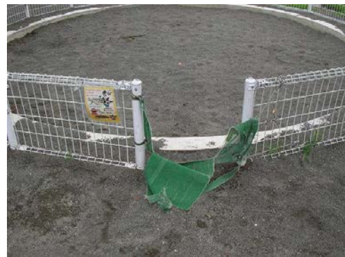
▲ 砂場柵入口の破損
