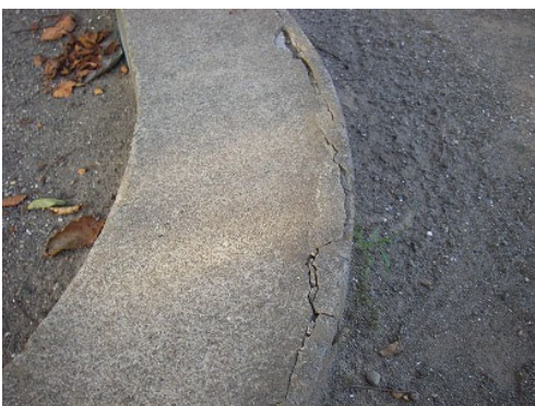
▲ 人研ぎ仕上げの割れ
