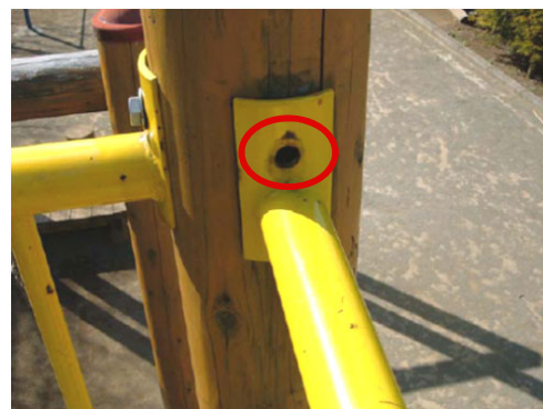
▲ 安全柵取り付け金具の欠落
