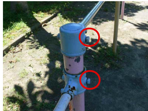
▲ ボルトの飛び出し
