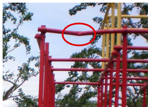
▲ 横部材の変形（曲がり）
