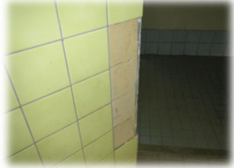
▲ 便所 壁面タイル破損
