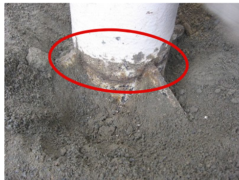
▲ 根際部の腐食及び亀裂
