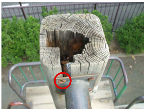
▲ 支柱天端の腐朽及びボルトの欠落
