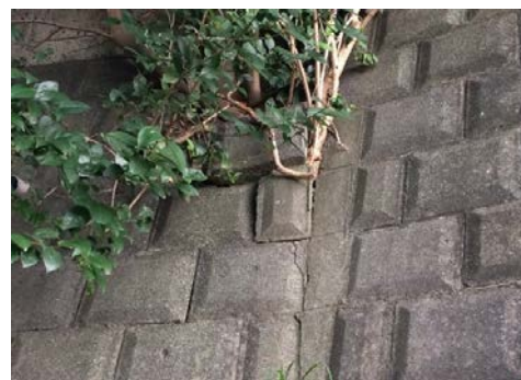
▲ 落下の危険があるブロック
