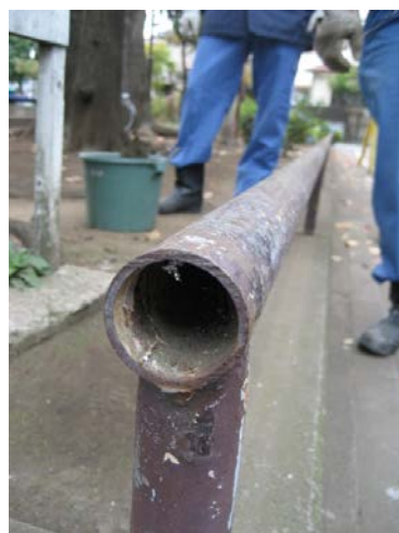
▲ パイプ柵 端部欠損
