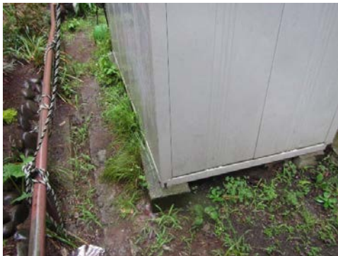
▲ 倉庫 基礎不良
