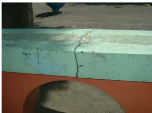
▲ コンクリートの亀裂
