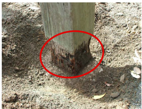
▲ 根際部の腐食（木製柱）
