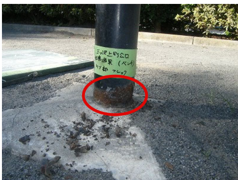
▲ あん馬ベンチ根際部の腐食（鋼製柱）
