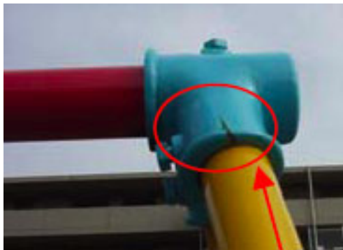
▲ 継ぎ手金具の割れ
