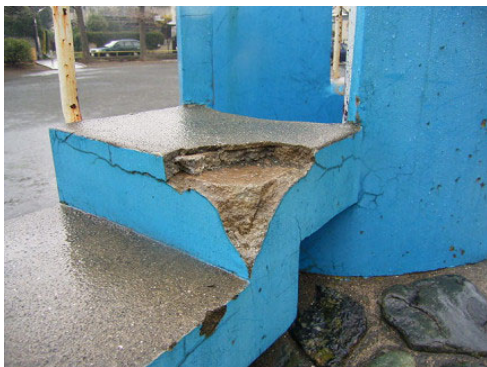
▲ コンクリートの破損
