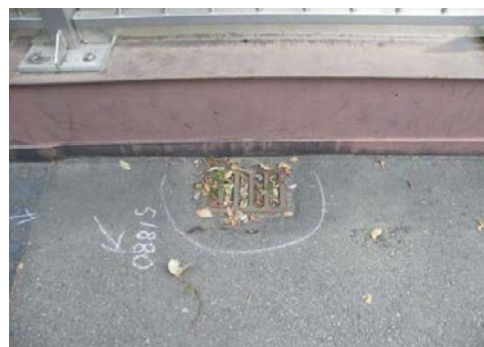
▲ 橋梁の排水施設土砂詰り
