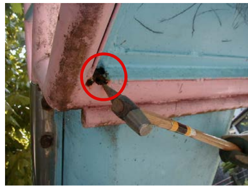
▲ 踊り場の腐食
