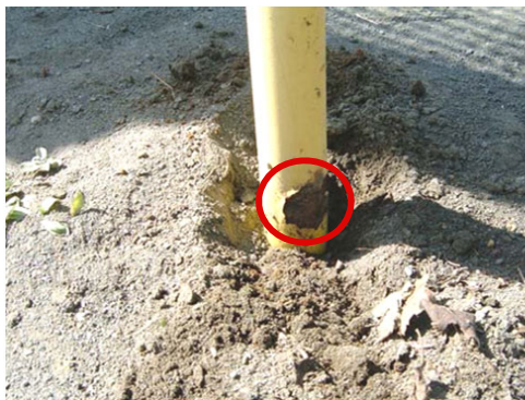
▲ 根際部の腐食（金属柱）
