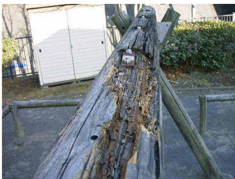
▲ ブランコ梁の腐食（木製）
