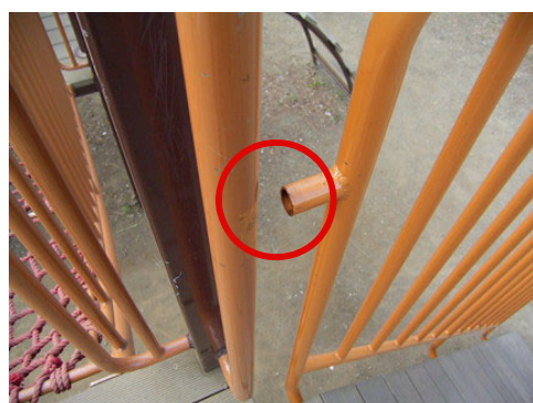
▲ 安全柵取り付け金具の脱落
