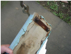
樹脂系素材の劣化状
