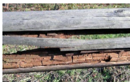
木材の腐朽 (褐色腐朽)
