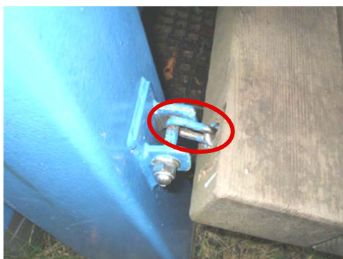
▲ 吊り橋取り付け部チェーンの摩耗
