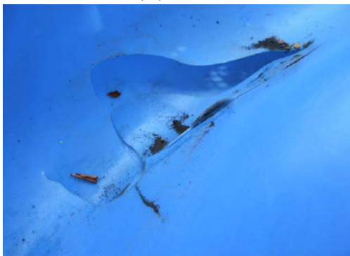
▲ スライダー滑降面の破損
