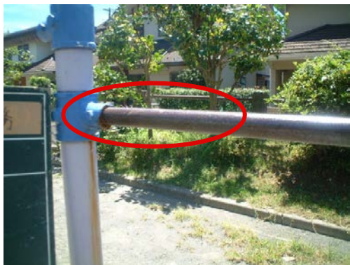
▲ 継ぎ手部分及び握り棒の錆
