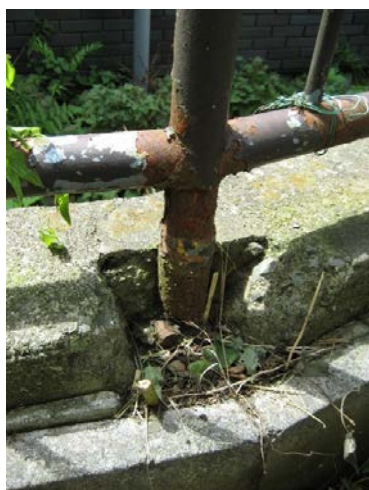
▲ パイプ柵 基礎破損
