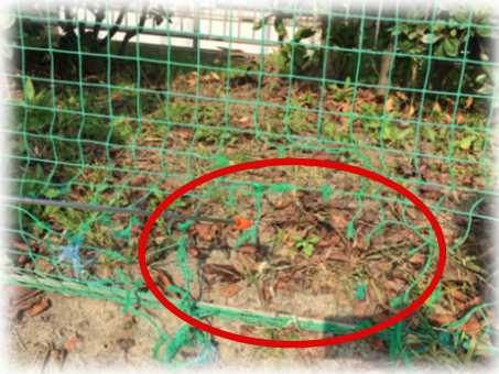
▲ 防球ネット ネット破れ
