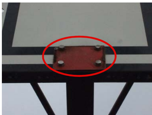
▲ バスケットゴール溶接部の破断
