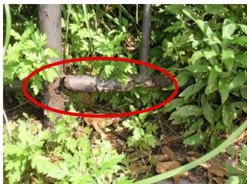
▲ パイプ柵 部材腐食
