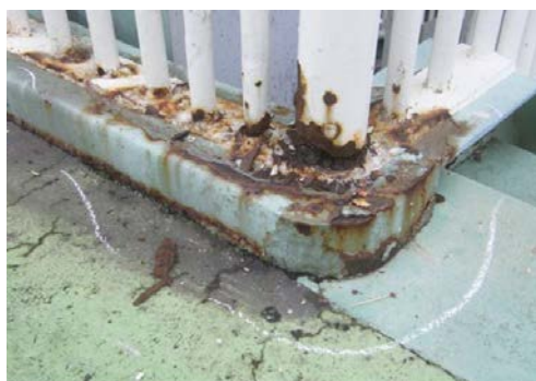
▲ 橋梁高覧（手摺り）の腐食
