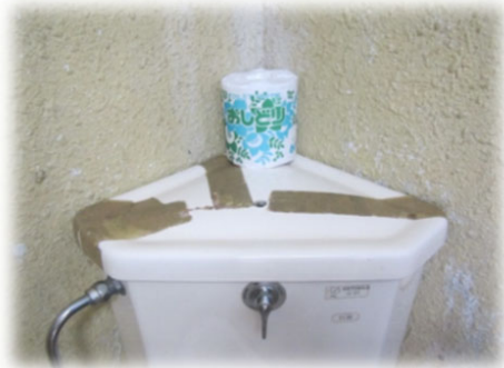
▲ 便所 タンク蓋破損
