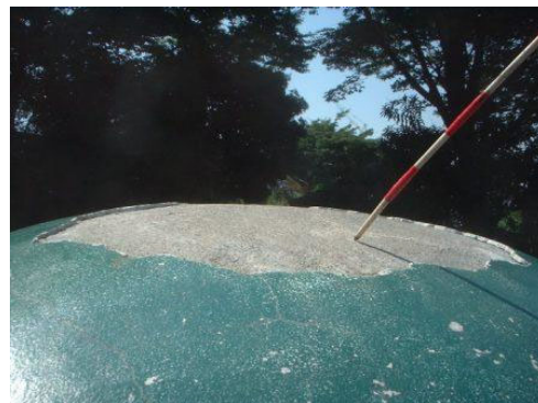
▲ モルタル部の破損
