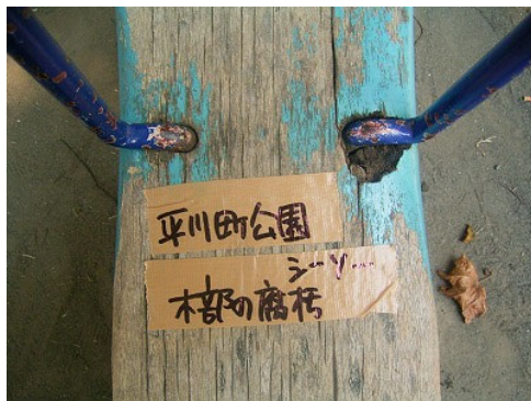
▲ 板の腐朽、取っ手のぐらつき
