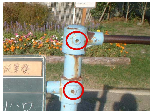
▲ 継ぎ手部分ボルト欠損
