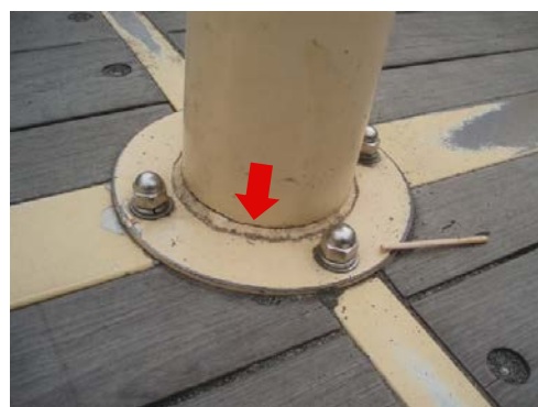
▲ フランジ溶接部の亀裂
