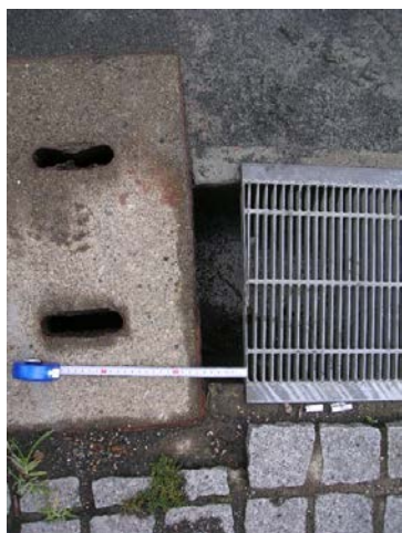
▲ グレーチング 隙間
