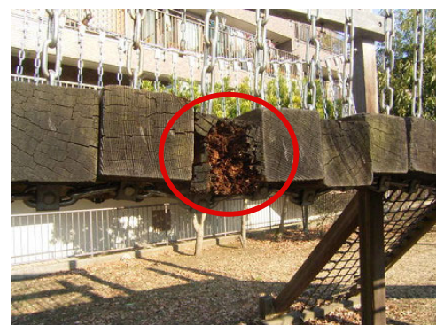
▲ 吊り橋部材の腐朽
