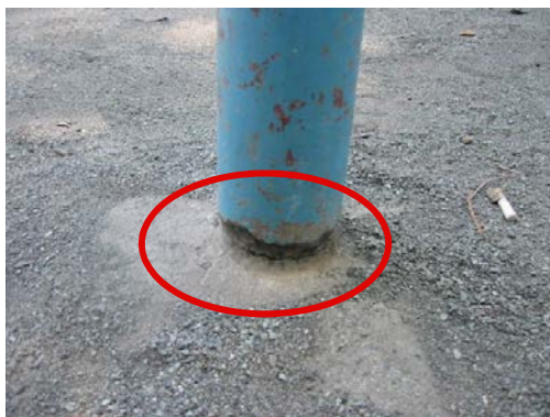
▲ 支柱地際部の腐食及び亀裂
