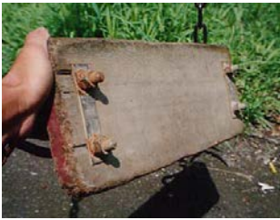
腐朽の初期段階
