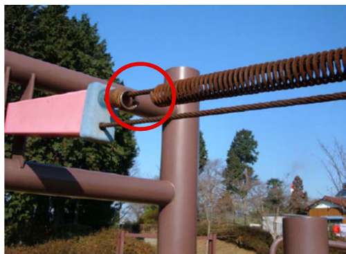
▲ 緩衝部（スプリング）の破損
