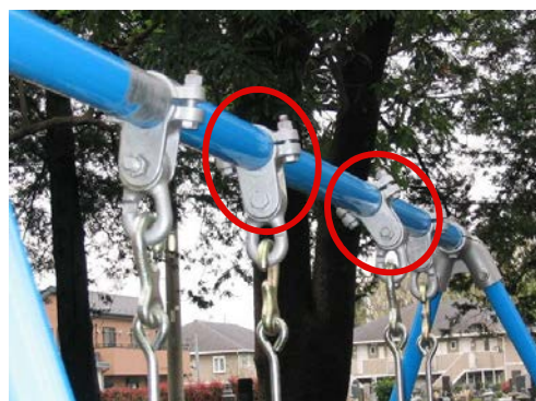
▲ 吊金具のずれ
