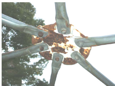
▲ 接続金具の腐食
