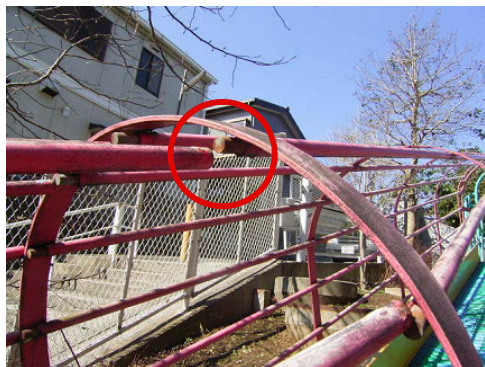
▲ 落下防止柵の接合部の破損
