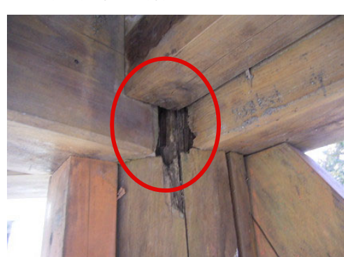
▲ 梁及び支柱の腐朽
