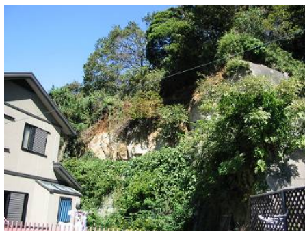
住宅にがけ崩れ
