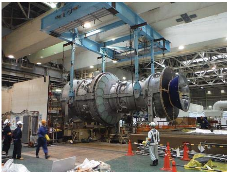
設備更新による効率化・高度化例(提供:東京電力フュエル&パワー株式会社)
