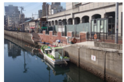
防災拠点や水上レクリエーションの 拠点として整備された船着場
