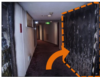
防火戸を開けた状態 ※点線部＝防火戸
