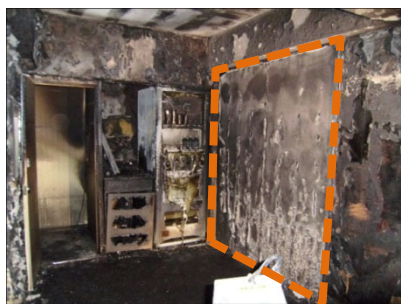
火災発生現場
