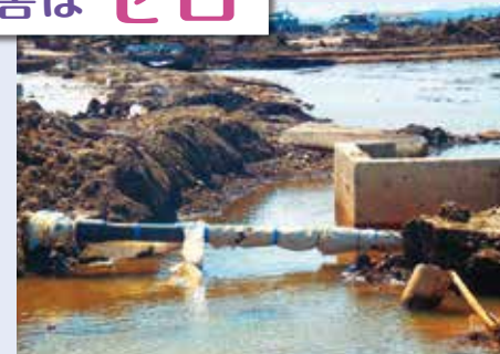
▲東日本大震災の津波にも耐えた耐震管(仙台市水道局提供)
