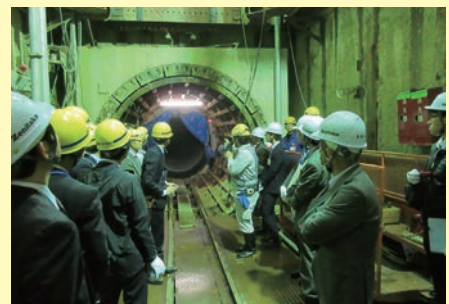
▲ 横浜市水道局・名古屋市上下水道局・新潟市水道局との技術交流会の様子
