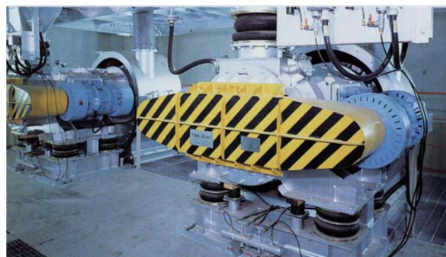
飛灰処理装置
