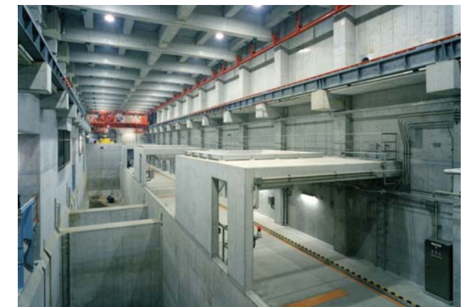
灰ピット・灰クレーン
