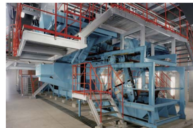
灰押し出し装置・灰搬出装置
