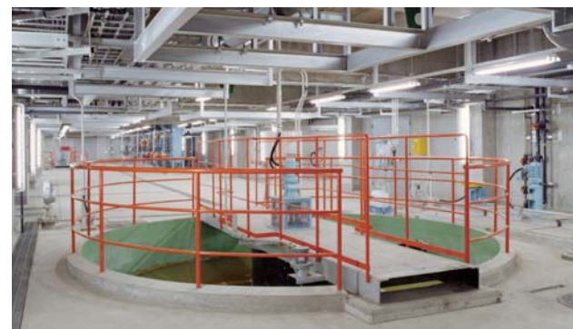
排水処理設備
