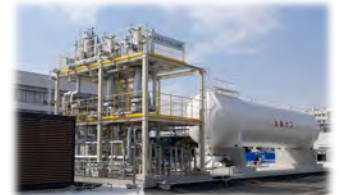
メタネーション実証(R4.4~) 【東京ガス株】 ※R5.7：ごみ焼却工場のCO2活用
