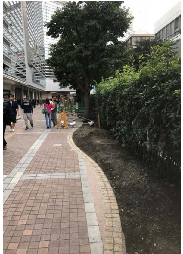
植栽帯は従来の直線形から柔らかいイメージの曲線形に変更されます
