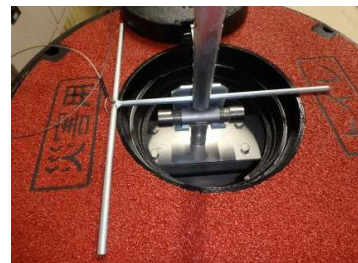
貯留弁の開状態
