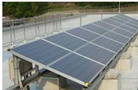
菊名ウォータープラザの太陽光発電設備
