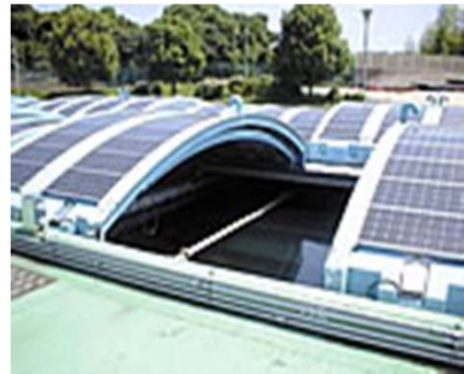
写真7 小雀浄水場の太陽光発電設備
