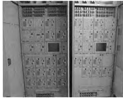
【更新後の ATC 装置】
