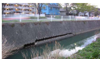
河川護岸の崩壊
