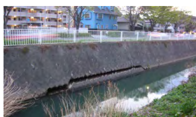
河川護岸の崩壊
